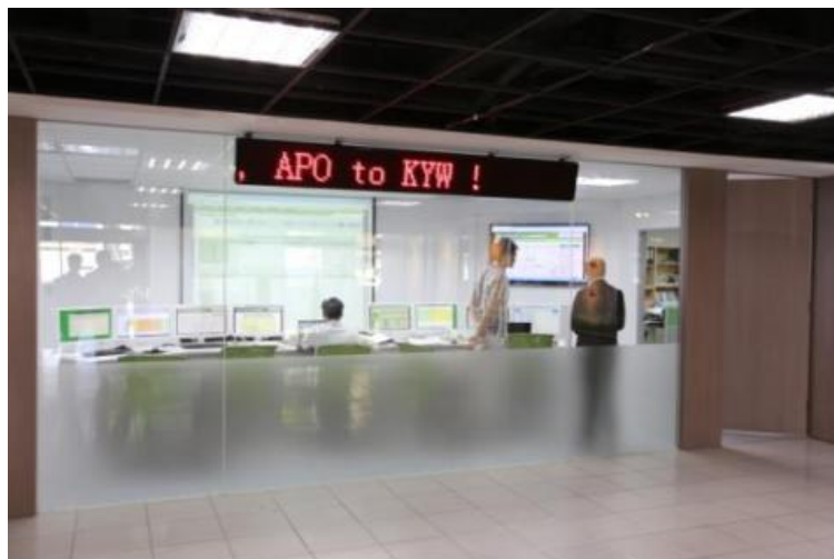
รูปที่ 4 ห้อง Control เพื่อใช้ Real time monitoring ข้อมูลของลูกค้า
