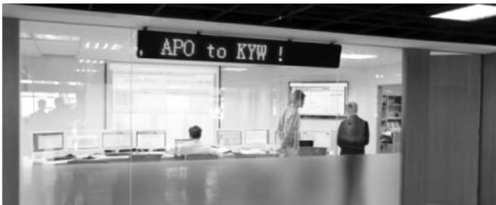
รูปที่ 5 : ห้องควบคุมเพื่อใช้ Real-time Monitoring ข้อมูลของลูกค้า
