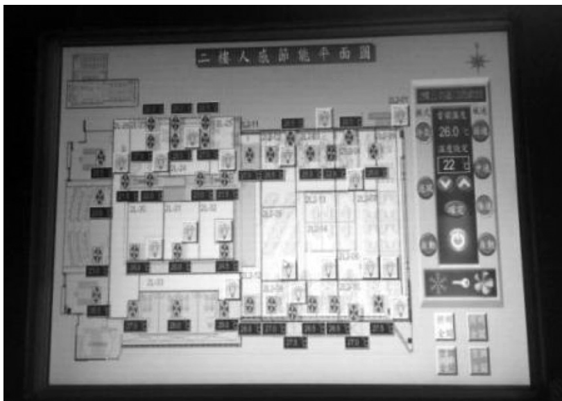
รูปที่ 7 : หน้าจอระบบสัมผัสสำหรับควบคุมการทำงานของระบบปรับอากาศและแสงสว่าง ซึ่งสามารถควบคุมได้ถึงรอบการหมุนของพัดลม
